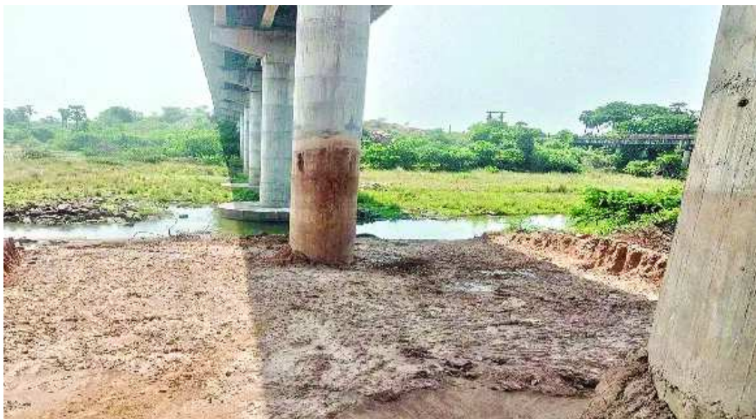
జామి, పతాకం న్యూస్: మండలంలోని భీమసింగ్గి కొద్దిరోజుల కిందట ఇక్కడ రైల్వే పనులు నిర్వహించే వంతెన కింద పిల్లరకు అనుసంధానంగా ఉన్న మట్టిని కాంట్రాక్టర్ తవ్వి తమ పనులకు వినియోగించారు. దీంతో
